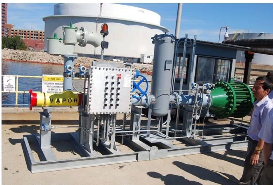
图 2-2 实地考察美国码头油气回收船岸界面安全装置
