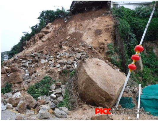
图 1 构嵯线 K2+220 修复前
