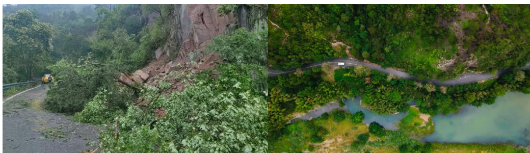
图 3 莲都区港周线 K1+800 暴雨边坡塌方修复前后对比
