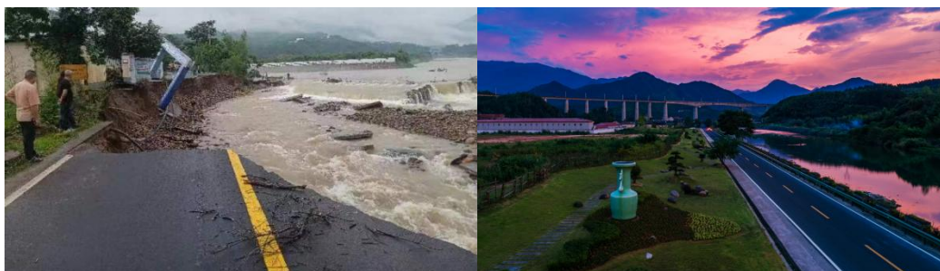
图2 龙泉市安豫线 K72+150 特大暴雨被冲断修复前后对比
