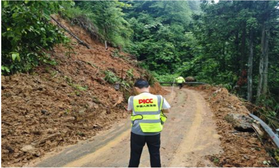
图1 交通—乡镇—保险公司三方联合查勘定损
