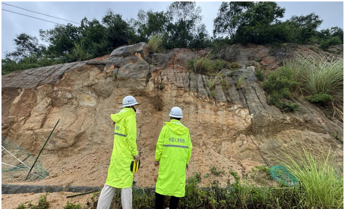
图 1 保险公司现场查勘灾毁情况
