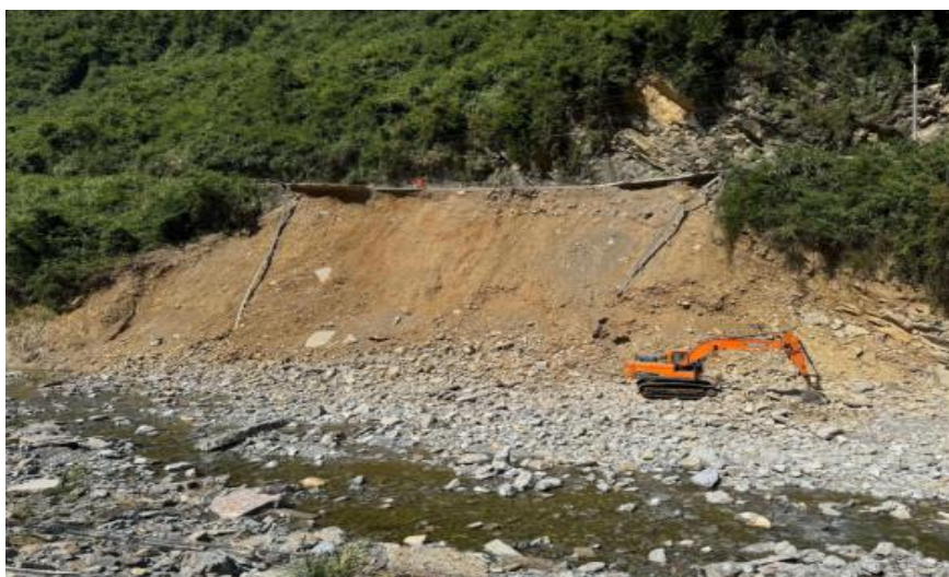
图 2 Y059 城北线 K0+800 路基修复前
