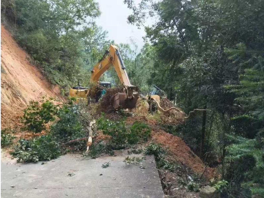
图 6 道路堵塞及时疏通
