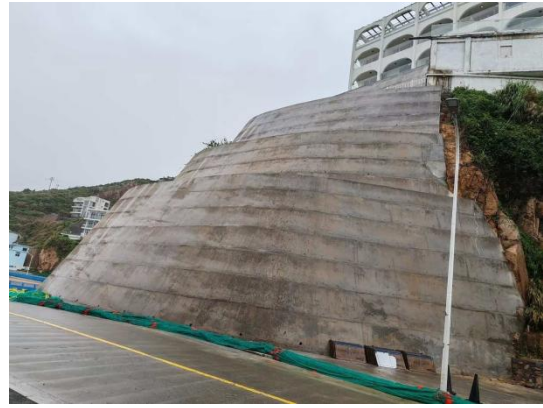
图 2 构嵯线 K2+220 修复后
