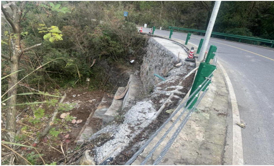
图 2 小柳线恢复现状
